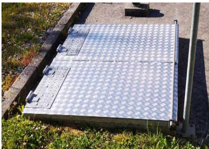
Trappes de la chambre de refoulement en aluminium Plus légères que les anciennes en acier galvanisé
