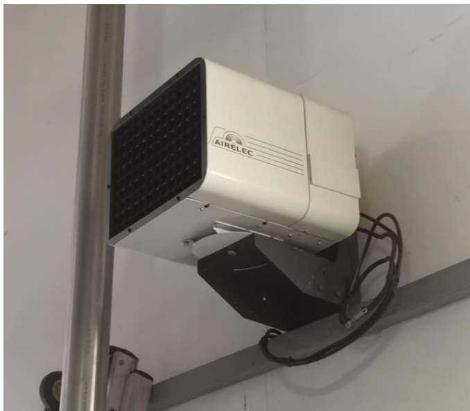
Aérotherme de chauffage station
